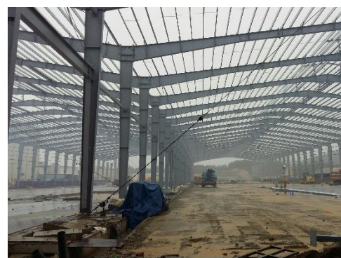
Nhà xưởng cho nhà máy CMC 2-3 và 2-4 được xây dựng đồng thời, bên trái là nhà máy 2-3, bên phải là nhà máy 2-4.
